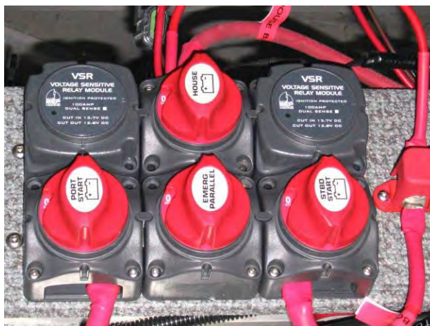
Commutateurs du système à trois batteries
